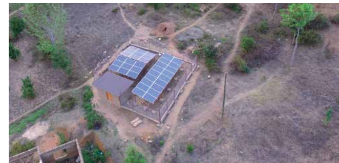
Photovoltaik mit Energiezentrale
